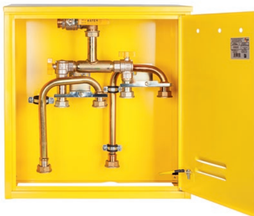
Punkt redukcyjno-pomiarowy na 2 gazomierze G4 w skrzynce metalowej
